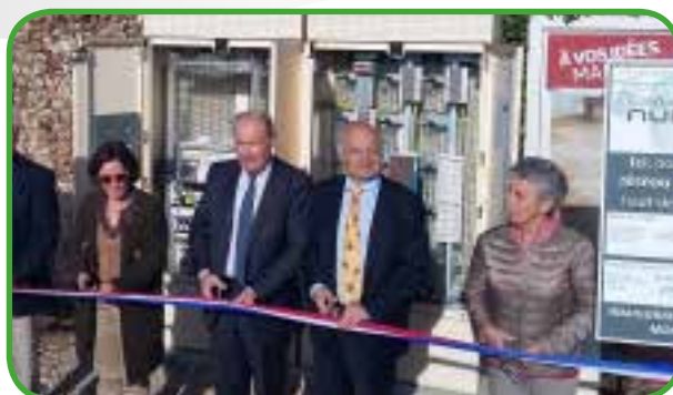
Inauguration de l'armoire de montée en débit sur la commune de Jaudrais
